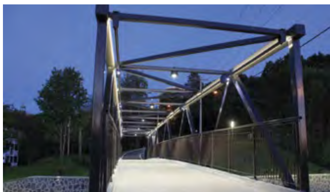
9 Éclairage de la passerelle de l'Avenue Station
